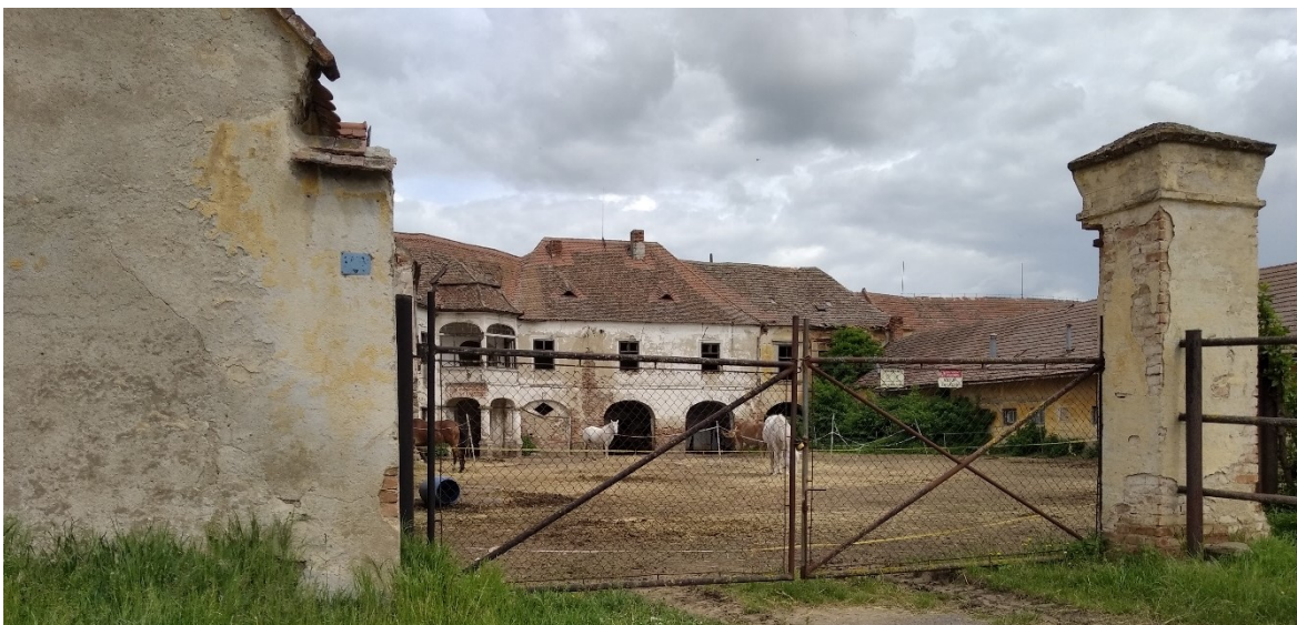
Obr. 13: Chátrající budova zámku Zdroj: Zdroj: ENVIPARTNER, s.r.o. (2021)
